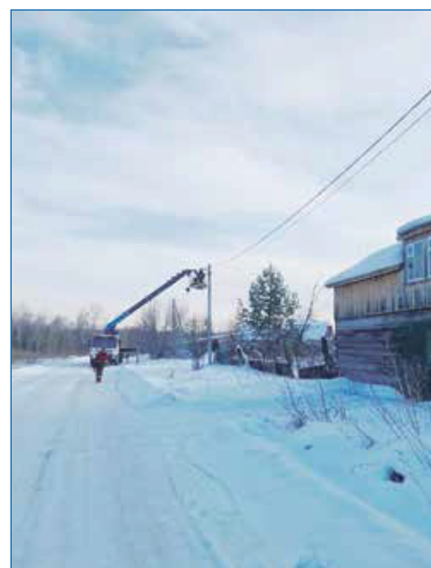
Современные линии наружного освещения в частном секторе
